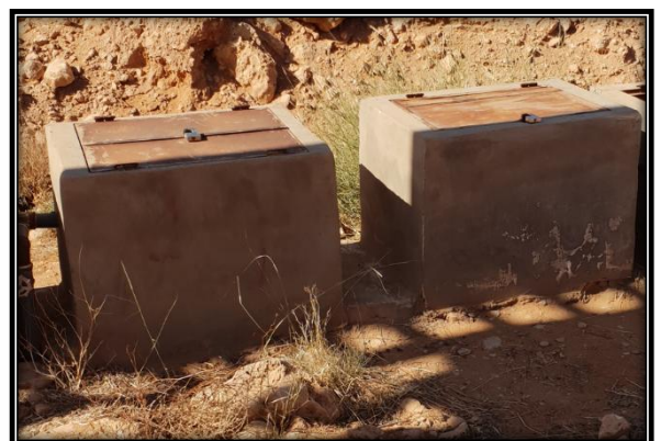
Photo 7 : Compteurs individuels / forage collectif
