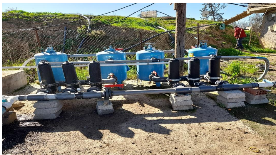
Photo 19 - CARI : Station de filtration de l'eau pour goutte à goutte et ferti-irrigation
